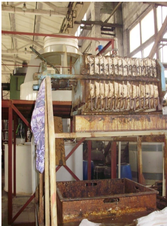
Рисунок 2.8 – Фото блоку обробки осадів системи очищення концентрованих стічних вод гальванічного виробництва ТзОВ «Завод метизних виробів»
