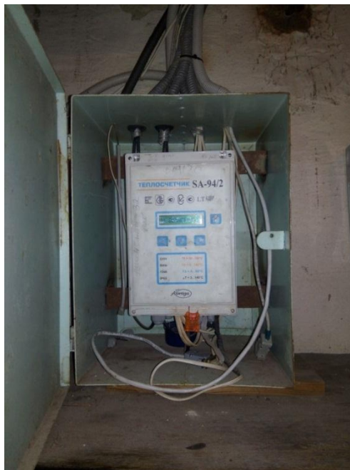
Рисунок 2.5 – Лічильник теплової енергії, марки SA – 94/2
