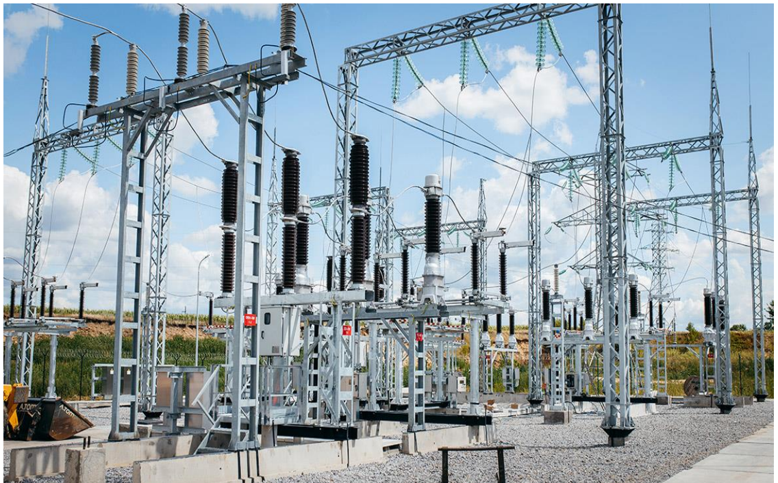
Рисунок 1.3 – Збірні шини підстанції
