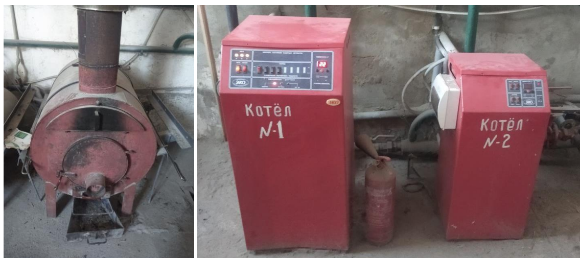
Рисунок 1.4 – Котел на твердому паливі
