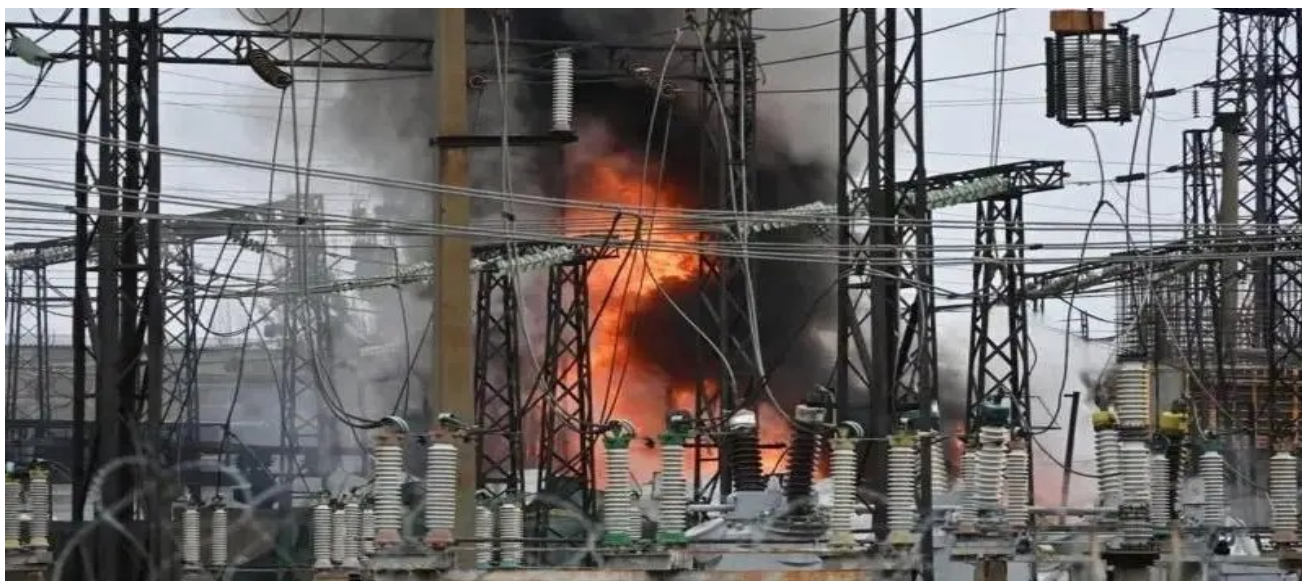
Рисунок Д.3 – Типові пошкодження високовольного автотрансформатора внаслідок влучання дрона-камікадзе
