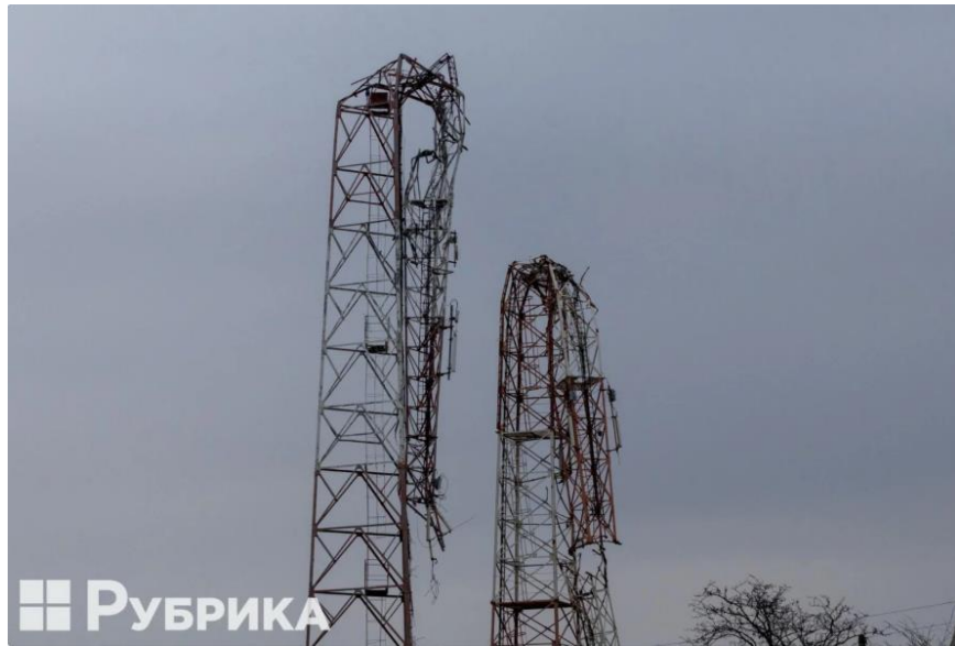
Рис. 2.7 Зруйнована вежа мобільного зв'язку на деокупованій Херсонщині.
