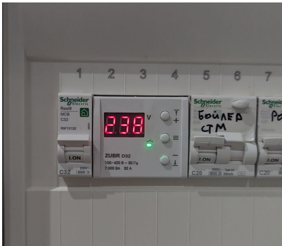
Рисунок 2.1 - Приклад ввідного автомату квартири (номінально потужність 7 кВт)
