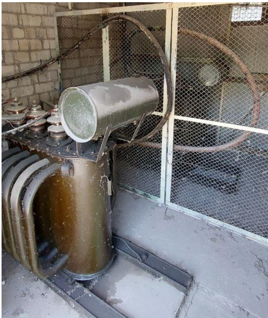
Рисунок 2.1 – ТП з трансформаторами ТМ-50/6/0,4
