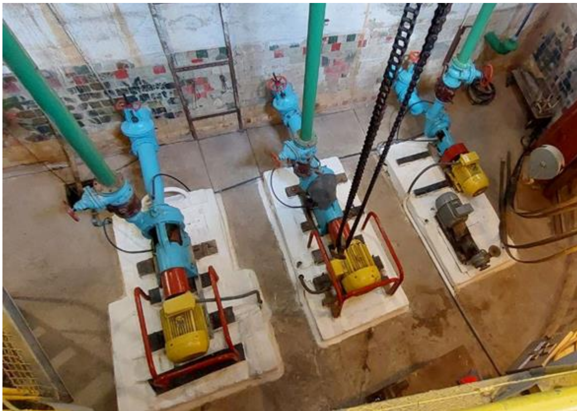
Рисунок 1.5 – Насосні агрегати станції
