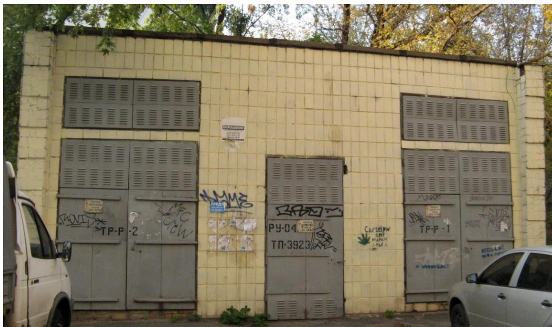
Рисунок 3.1 – Зовнішній вигляд трансформаторної підстанції ТП-3923
