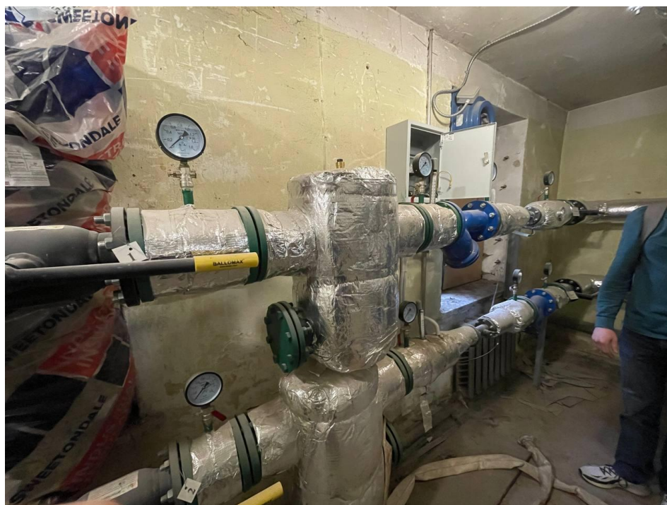
Рисунок 2.18 – Загальний вигляд трубопроводів системи опалення
