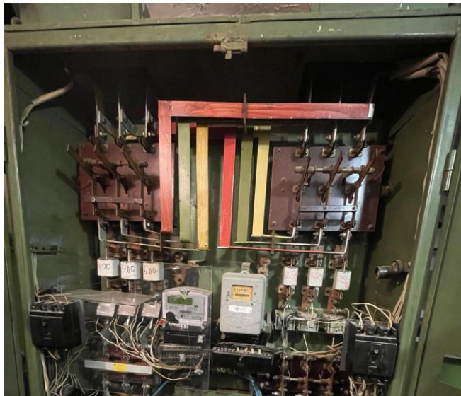
Рисунок 3.2 – Зовнішній вигляд електрощитової
