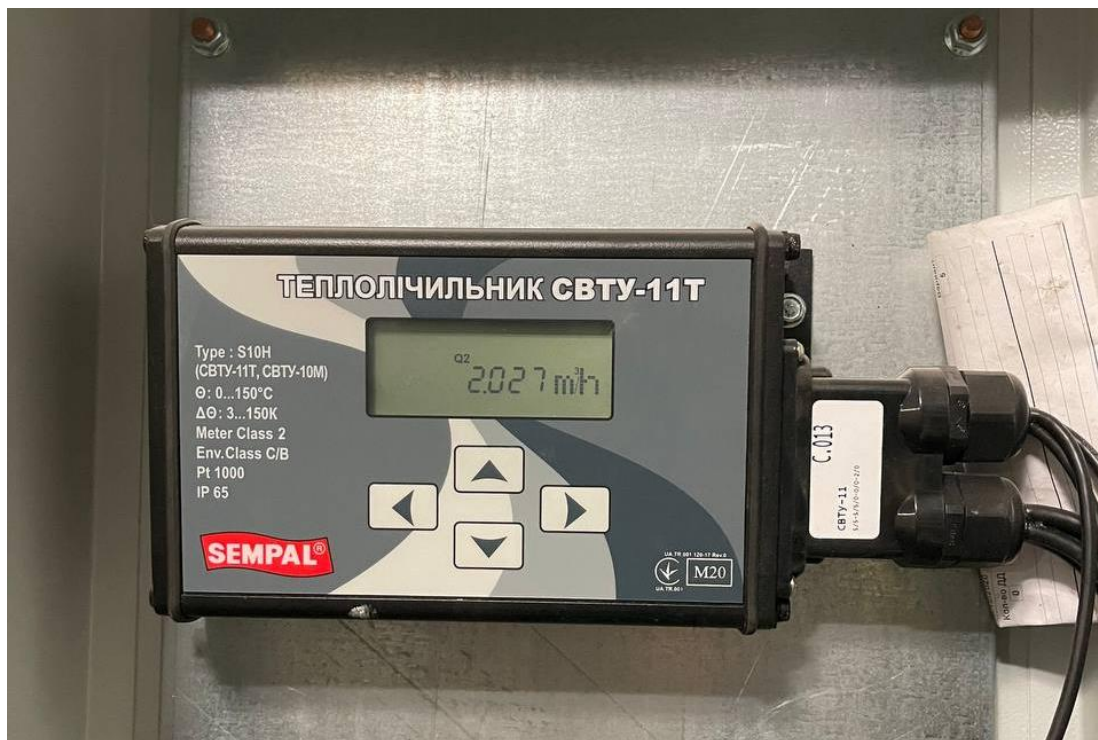
Рисунок 2.2 – Зовнішній вигляд лічильника вузла теплового входу
