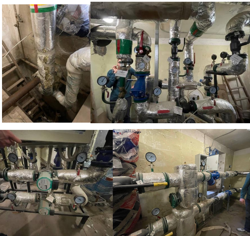
Рисунок 2.1 – Зовнішній стан теплового пункту, який розташований у будівлі
