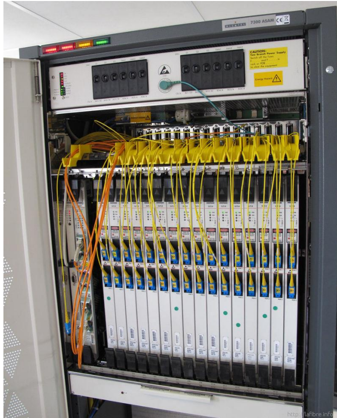
Рисунок 1.5 - Загальний вигляд OLT
