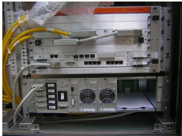
Рисунок 2.3 - Загальний вигляд обладнання від компанії Siemens (DSLAM SURPASS hiX 5625)
