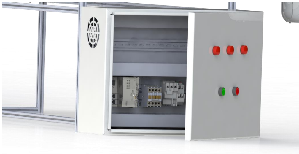
Рисунок 2.13. Електрична шафа конвеєра
