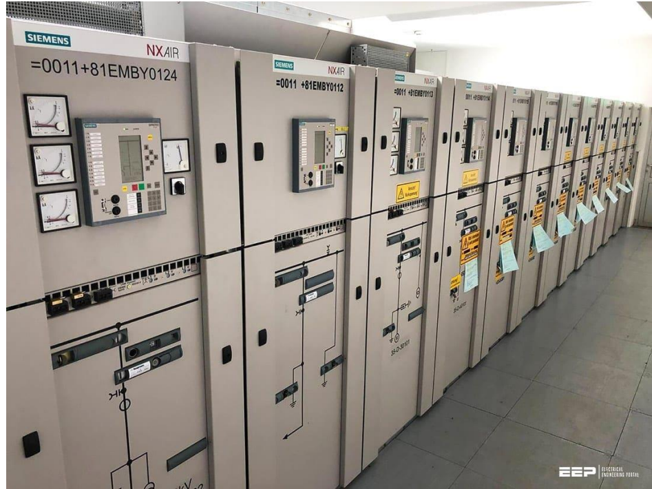
Рисунок 5.2 Приклад комірок з повітряною ізоляцією типу nxAIR
