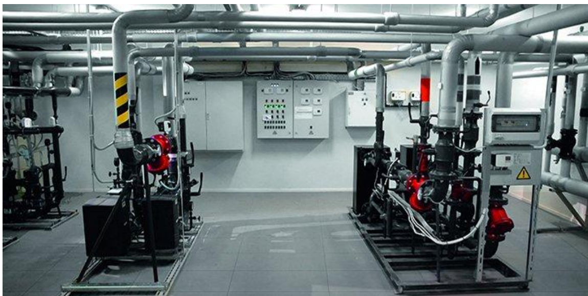
Рисунок 1.1 — Індивідуальний тепловий пункт
