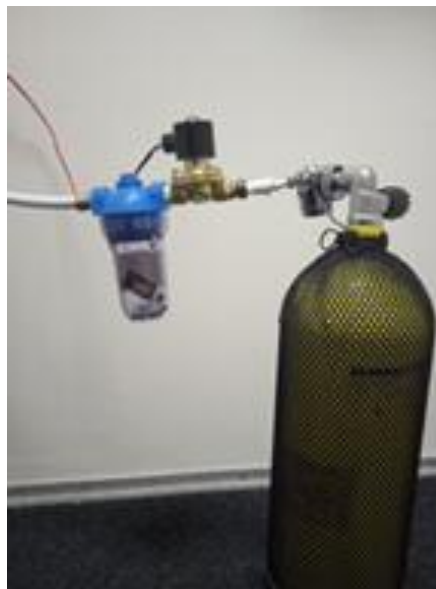
Рисунок 4.7 — балон встановлений в приміщенні
