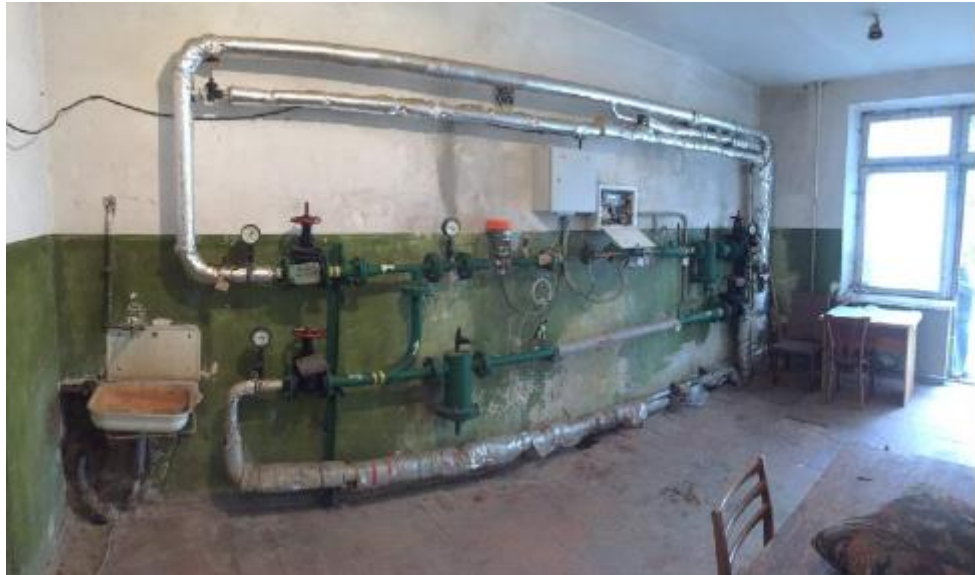
Рисунок 1.5 – Обладнання ІТП навчального корпусу №16 НТУУ «КПІ ім. Ігоря Сікорського»
