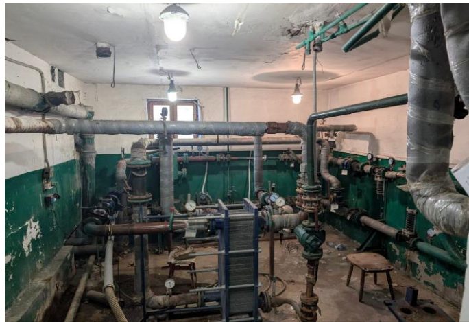
Рисунок 1.5 – Тепловий пункт будівлі з елементами системи опалення та ГВП
