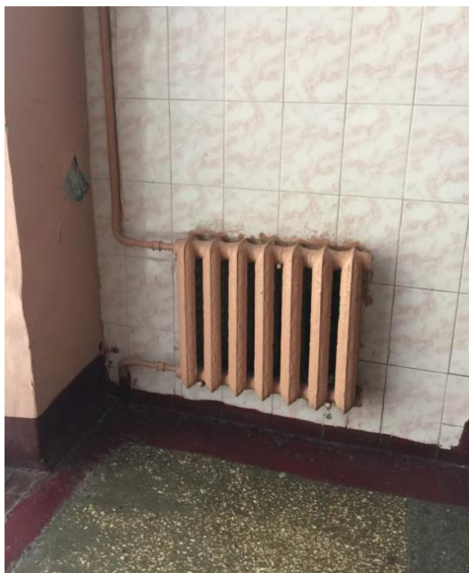
Рисунок 1.2 – Опалювальний прилад об'єкту – радіатор.
