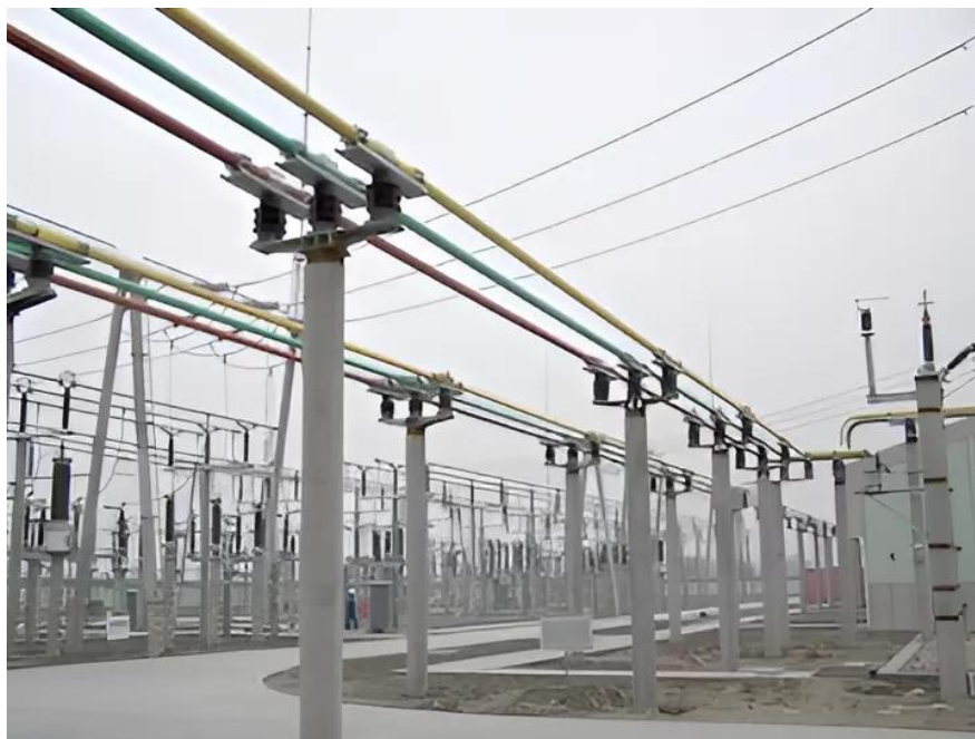
Рисунок 1.4 – Збірні гнучкі струмопровідні шини підстанції (10кВ)
