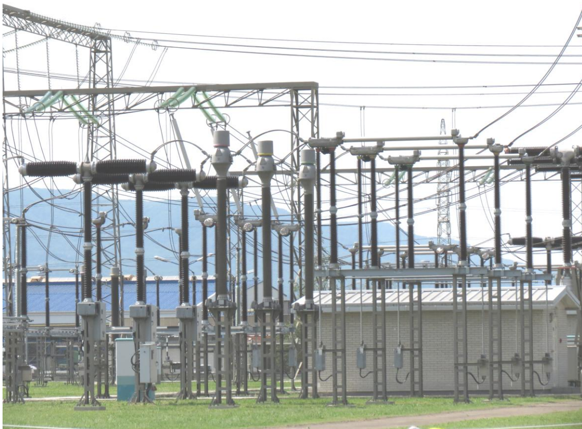
Рис. 4.37. Загальний вигляд відкритого розподільного пристрою підстанції
