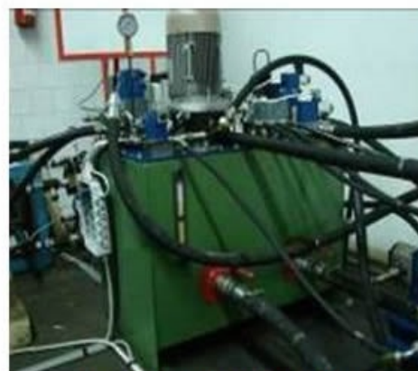
ф) гідравлічна станція
