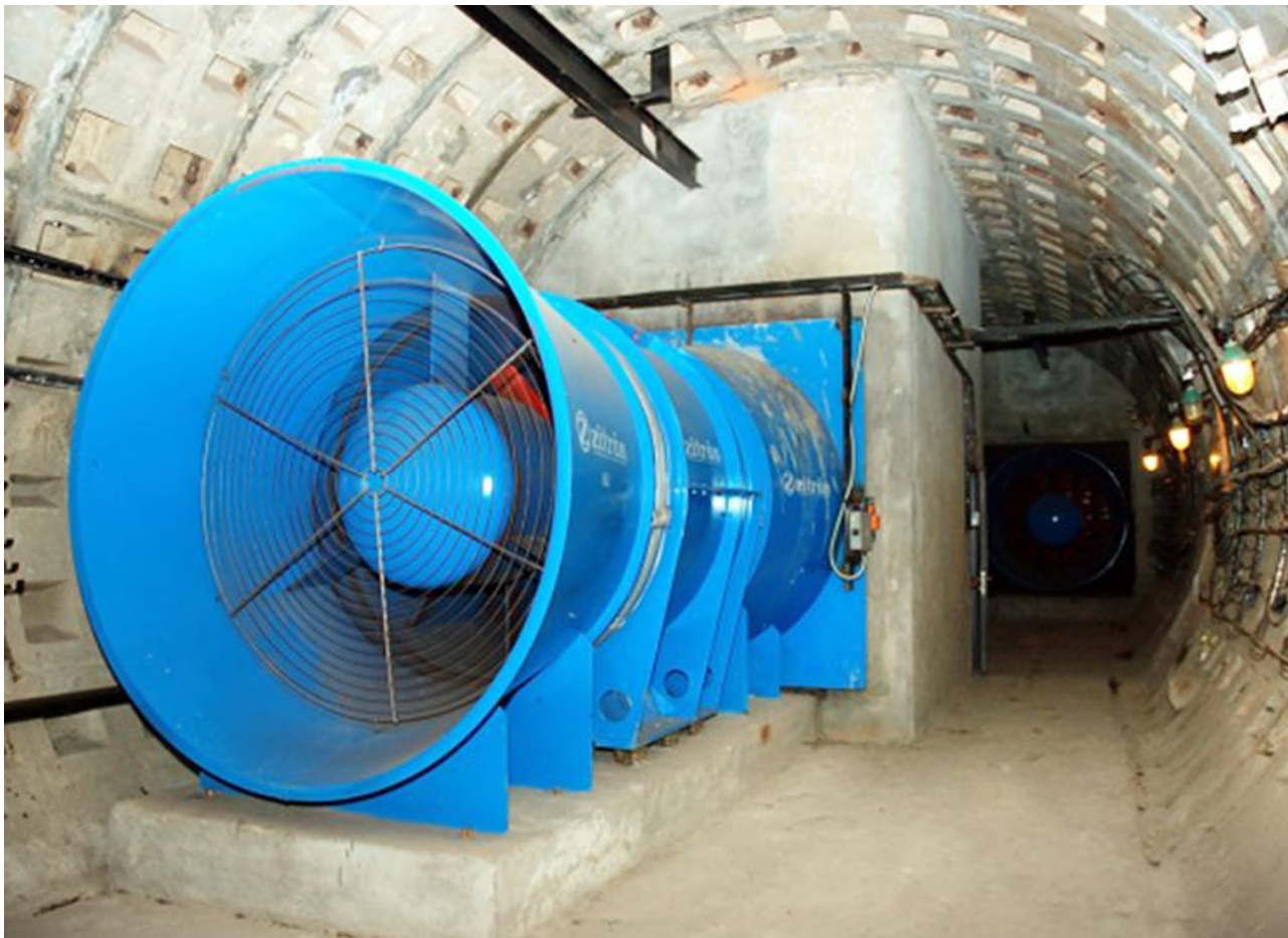
Рис.1.2. Вентилятори Zitrion у вентустановці метрополітену.
