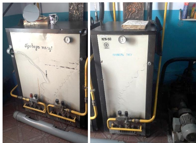
Рисунок 2.16 – Зовнішній вигляд котельного обладнання
