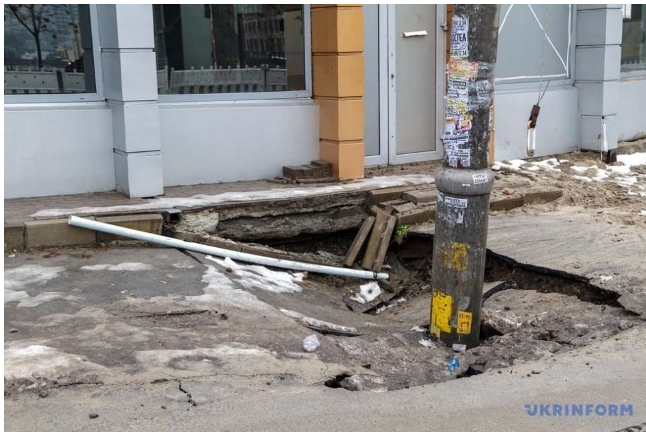
Рисунок 2.2 – Просідання ґрунту поблизу станції метро «Деміївська» [20]
