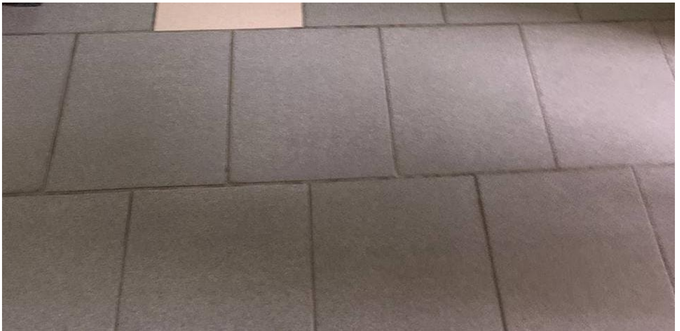
Рисунок 3.5 – Підлога покрита шаром плитки
