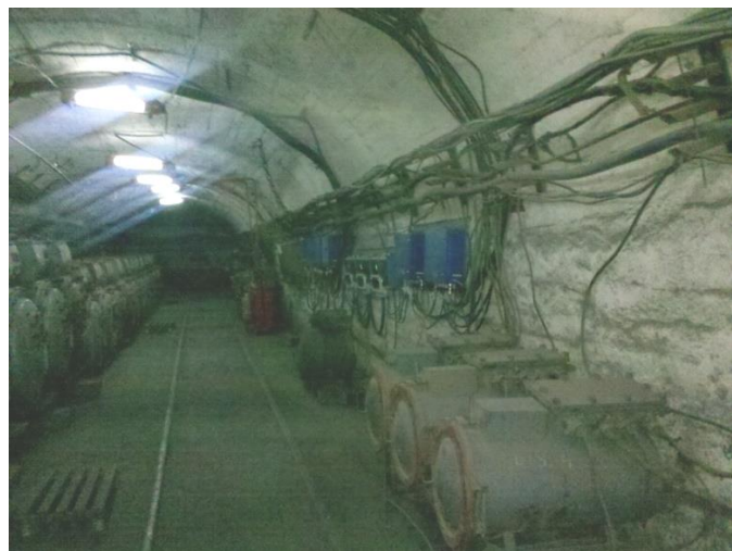
Рисунок 1.8 - Оптоволоконні лінії та лінії мобільного зв'язку в штреці шахти на шляху до водовідливної установки
