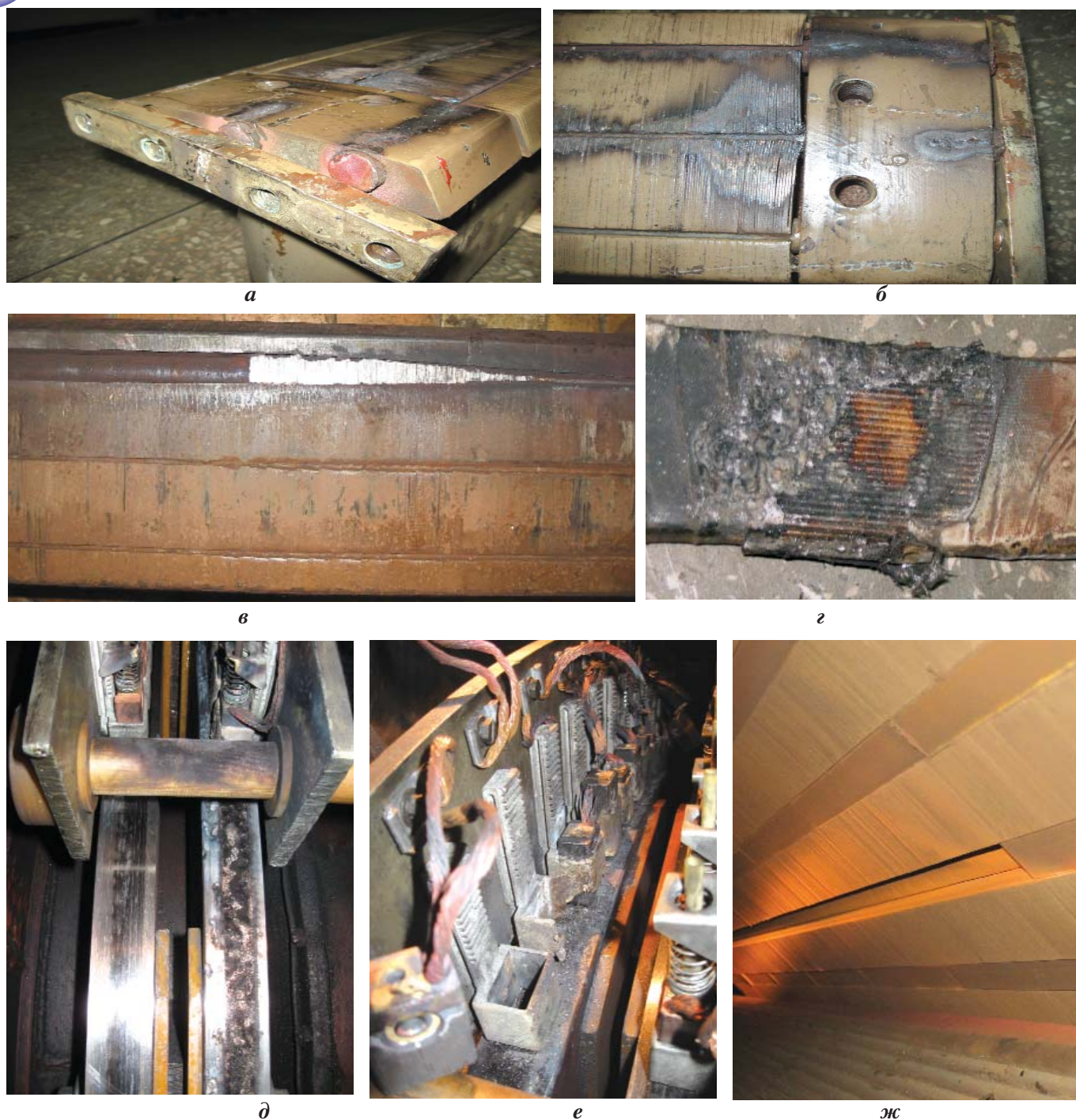
Рис. 1. Ушкодження, що мали місце при експлуатації капсульного гідрогенератора типу СГК 538/160–70М.
