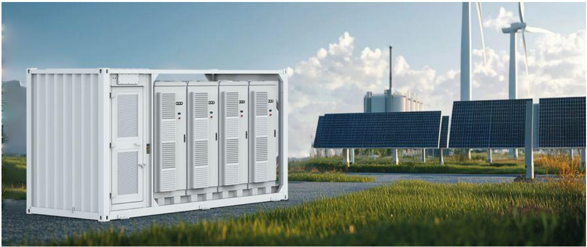
Рисунок 4.1 – Зовнішній вигляд контейнерної системи накопичення енергії
