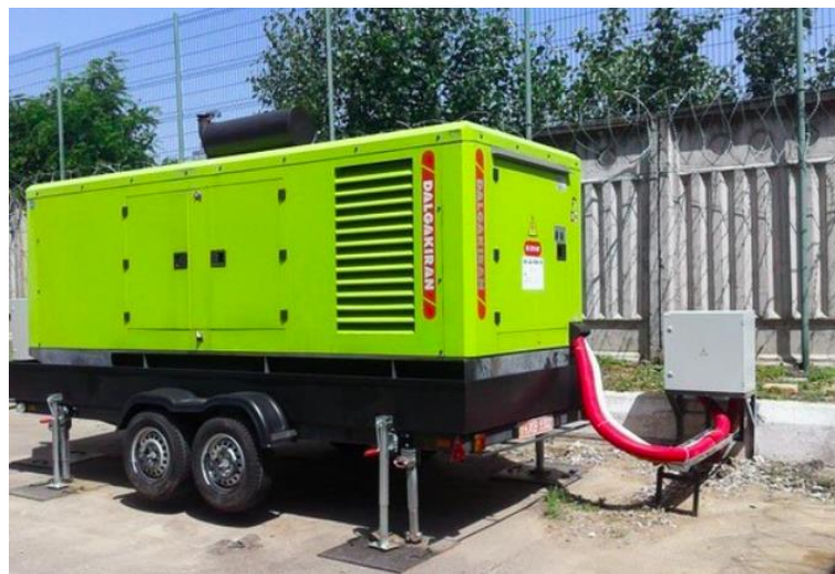
Рисунок 2.1 - Автономна дизельна електростанція
