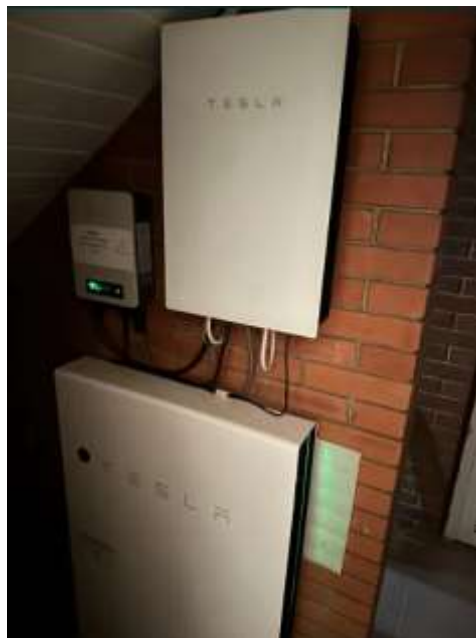
Рис.2.4. Система зберігання енергії Power Wall з контролером
