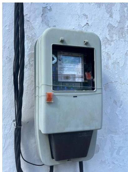
Рисунок 2.8 – Зовнішній вигляд приладу обліку
