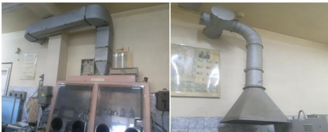
Рисунок 4.2 – Система вентиляції в лабораторному приміщенні
