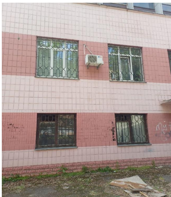
Рисунок 1.2 – Існуючий стан віконних конструкцій навчального корпусу № 31
