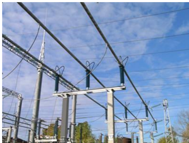
Рисунок 2.8 – Збірні шини підстанції
