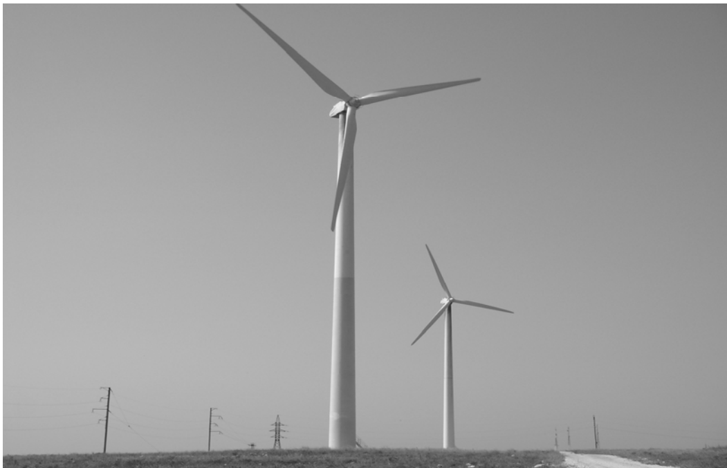
Рис. 5. Ветроэлектрическая установка Т-600-48
