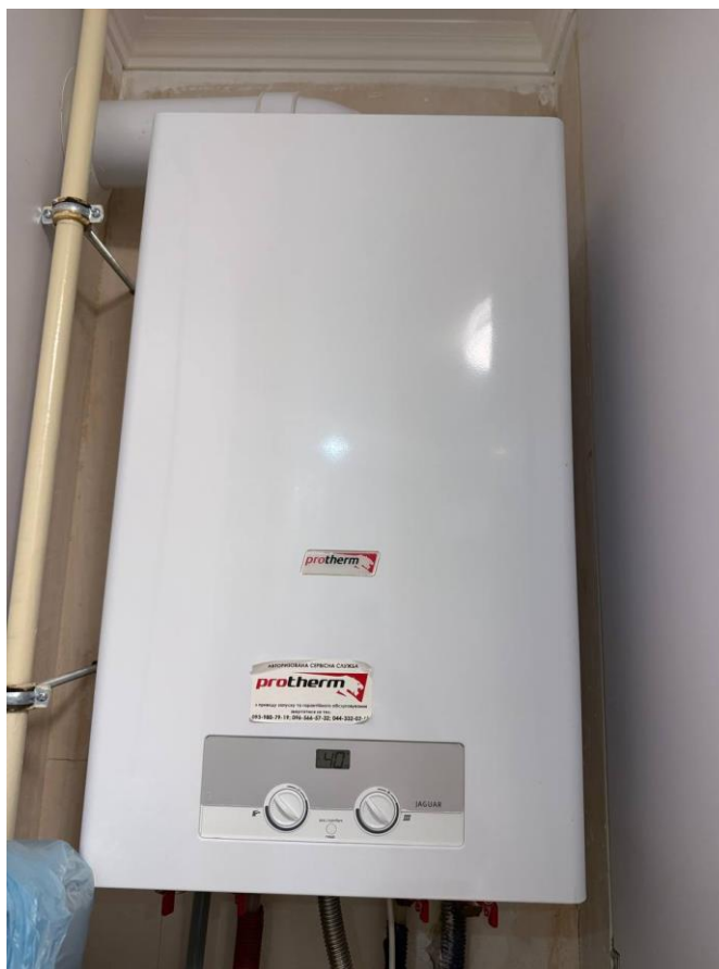
Рисунок 2.2 – Встановлений котел в квартирі
