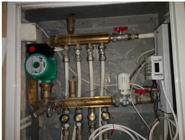
Рис. 2.3– Розподільчий пункт системи опалення першої половини будинку
