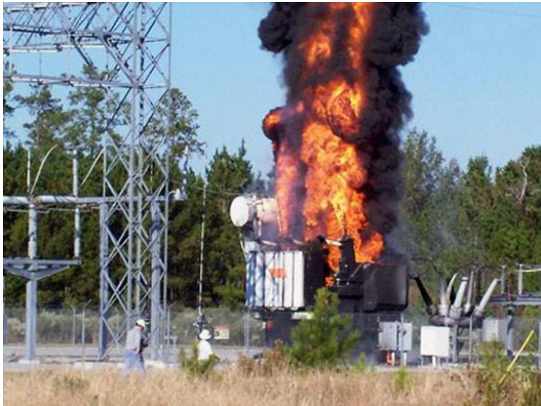
Рисунок 4.2 – Загоряння трансформатора в наслідок КЗ
