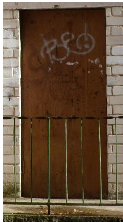
Рисунок 2.4 – Аварійні металеві двері
