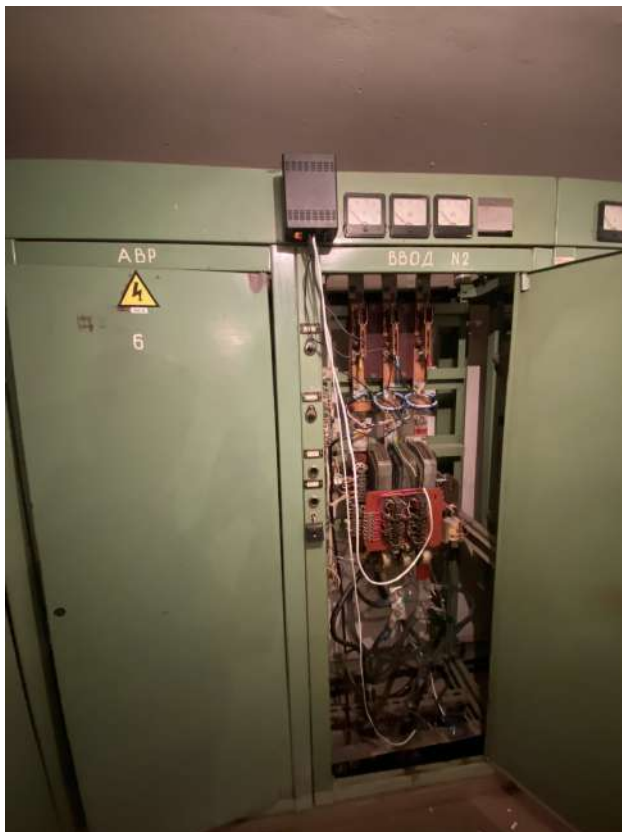
Рисунок 2.5 – Встановлений пристрій моніторингу в щитовій
