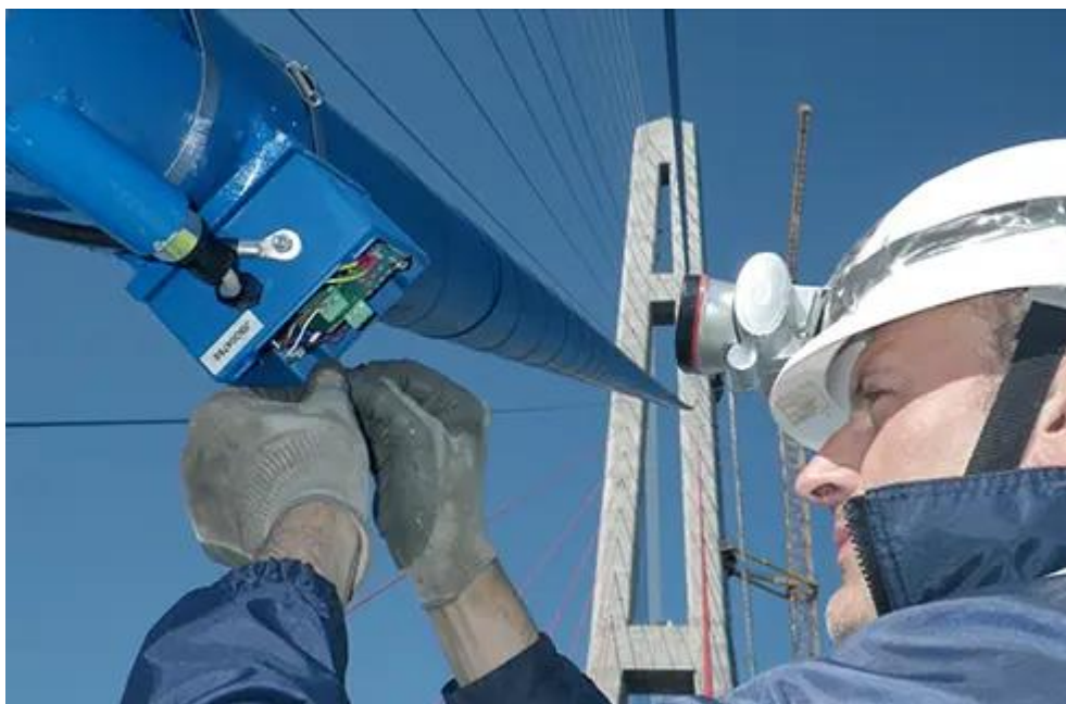
Рисунок 2.2 – Встановлення системи «EverSense» [3]
