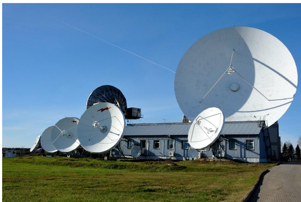
«Рис. 1.2.1 — Земна станція»
