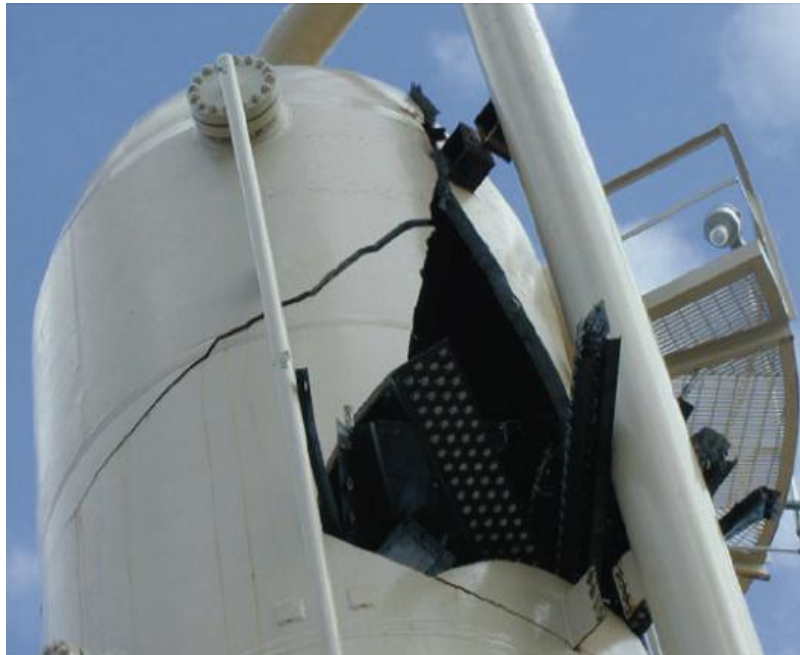
Рис. 5.6. Промислова конструкція, зруйнована за крихким механізмом [5.1]
