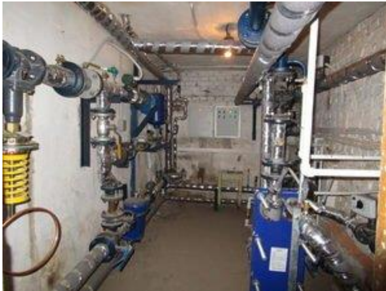
Рисунок 4.1 – Приміщення теплового пункту
