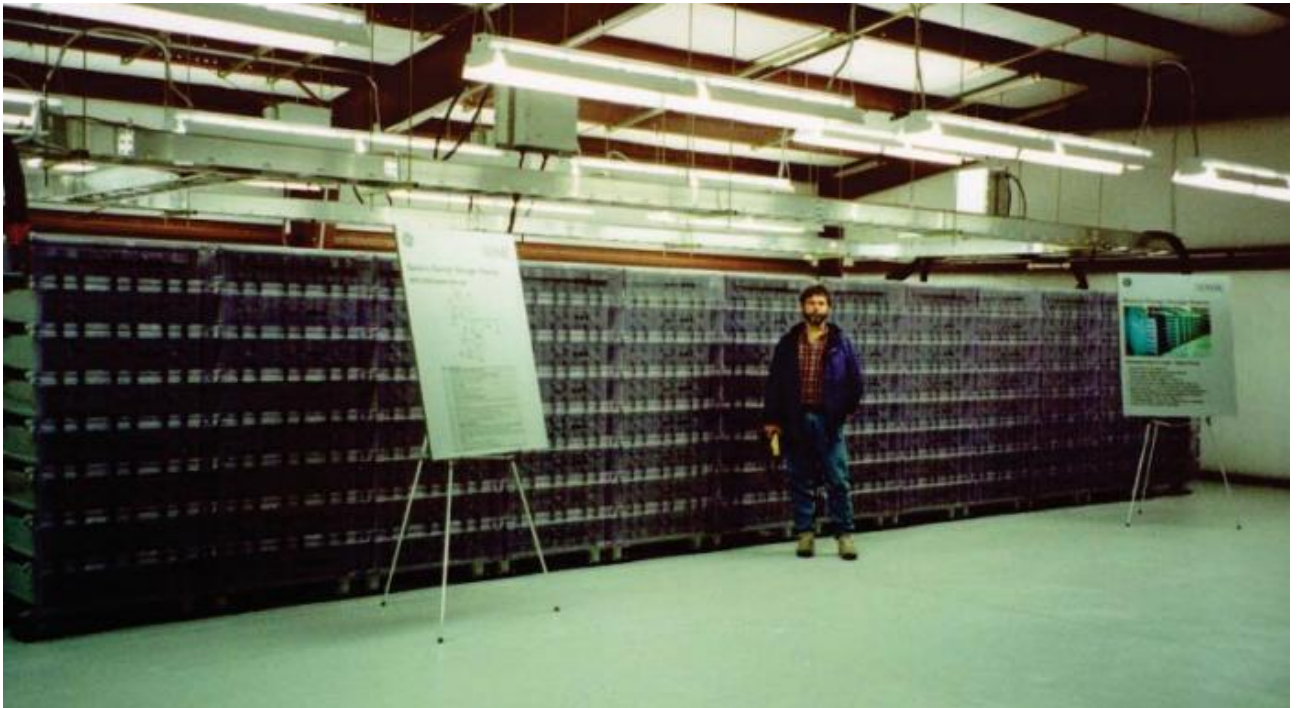
Рисунок 1.5 – 1МВт/1.5МВт*год свинцево-кислотного УЗЕ встановлений у місті Метлакатла на Алясці[8]
