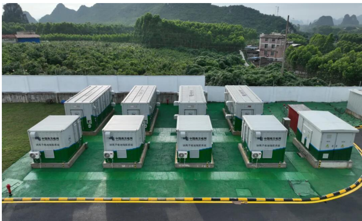
Рисунок 1.7 - Натрій-іонний акумулятор потужністю 10 МВт·год від China Southern Power Grid у китайському регіоні Гуансі-Чжуан[9]
