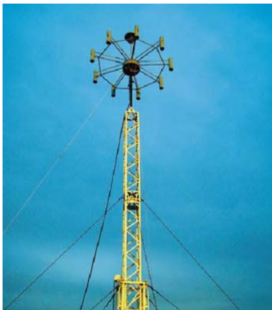
Рис.1.1. Стаціонарна станція радіомоніторингу.
