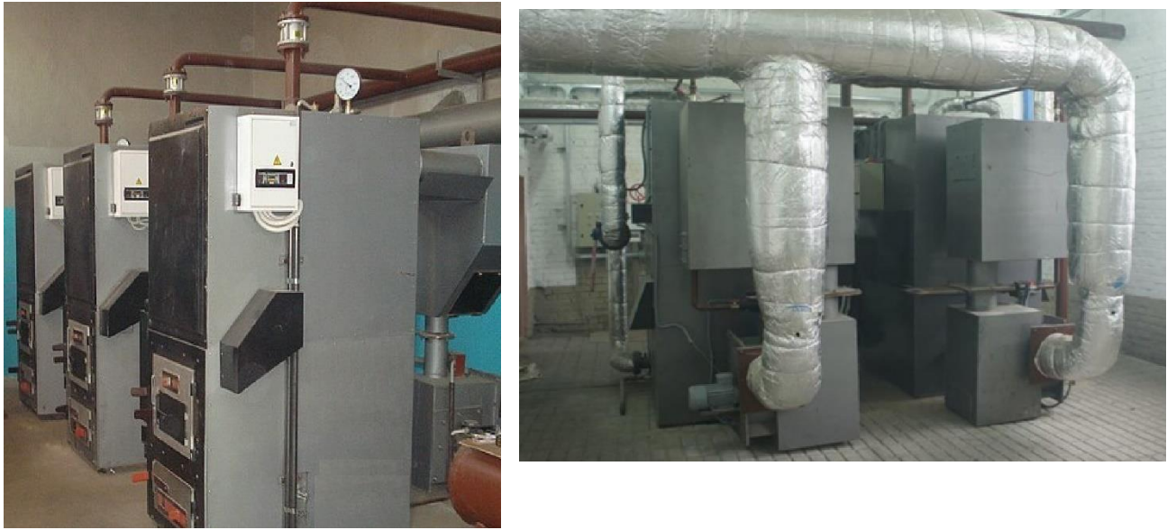
Рисунок 2.1 – Котельня з введеними до експлуатації котлами марки КВГТ
