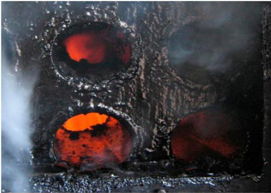
Рисунок 2.18 – Результат утворення конденсату в теплообміннику котла
