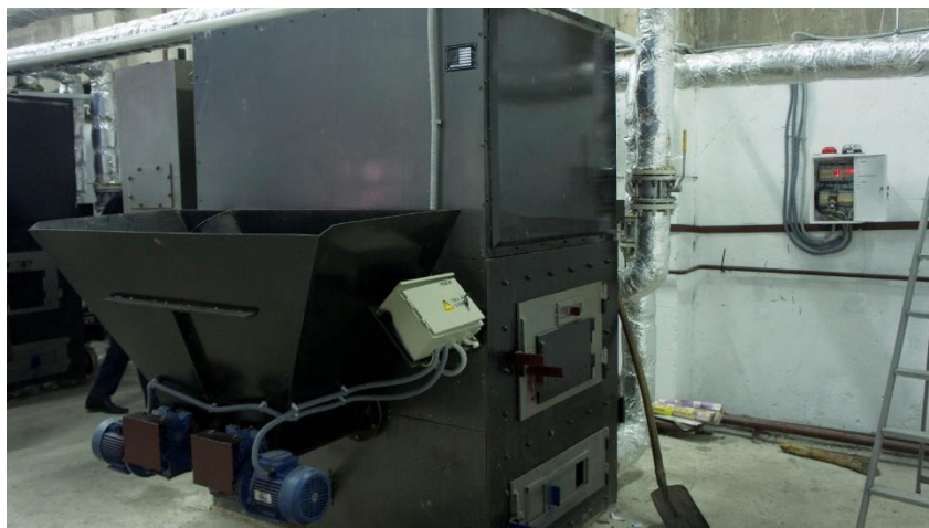
Рисунок 3.4 – Підготовка котла перед запуском
