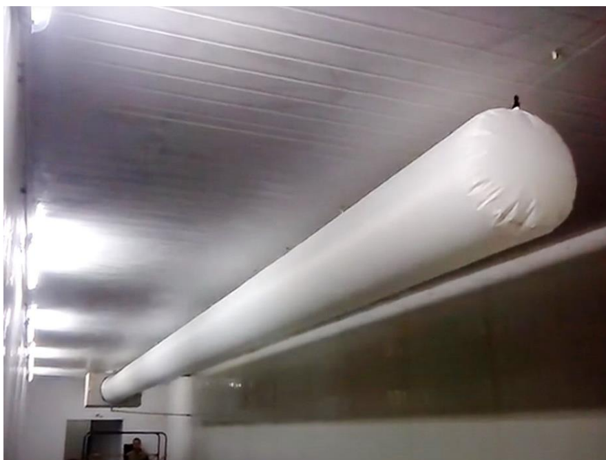
Рис. 5.11 Загальний вигляд текстильного повітропроводу
