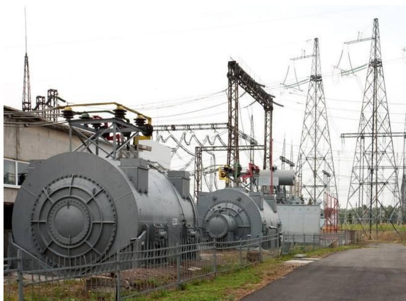
Рисунок 1.3 - Синхронний компенсатор на підстанції 750 кВ
