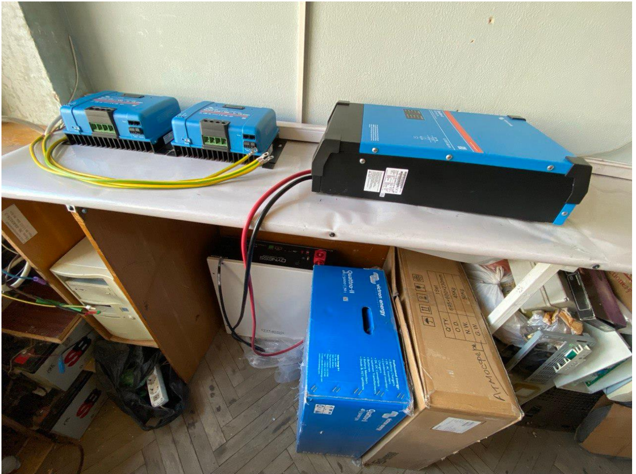
Рисунок 2.1 — Початкове розміщення обладнання в 429 ауд. 20-го корпусу КПП: в лівому верхньому куті контролери заряду Victron Energy BlueSolar MPPT 250/100-Tr VE.Can; праворуч інвертор Victron Energy Quattro II 48/5000/70-50/50; знизу АКБ Dyness A48100
