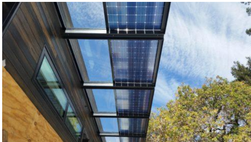
Рисунок 1.5 — Змонтовані безрамні двосторонні фотомодулі на наявному об'єкті [6]
