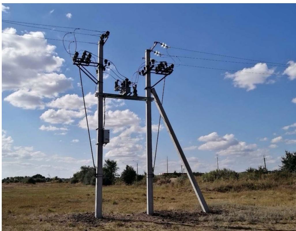
Рисунок 1.1 – Реклоузер на двох опорах [5]
